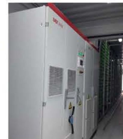
3-1 易事特4.4MWh集装箱储能电站项目
