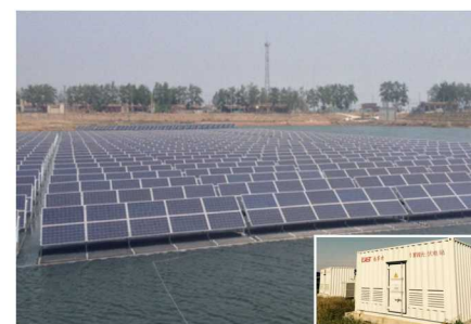
亚洲最大水面光伏电站
