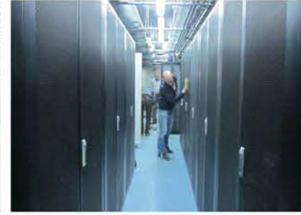
约旦通信大数据中心
