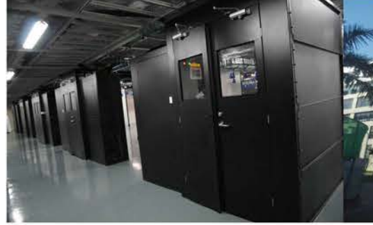
广州百度IDC数据中心
