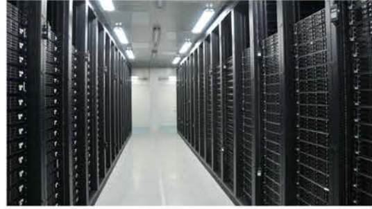
腾讯T-block数据中心(中国移动最先进的数据中心)
