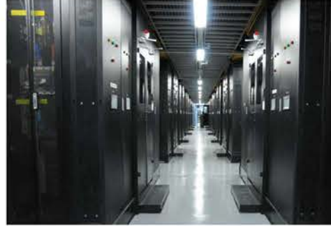
广州腾讯IDC数据中心
