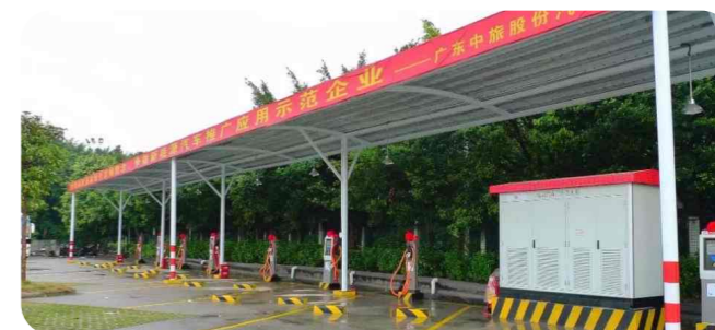
白云体育馆停车场充电站
