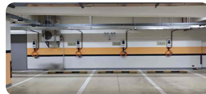
中国联通总部的停车库充电站
