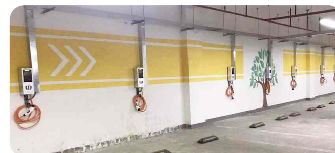
深圳星悦居地下车库充电站
