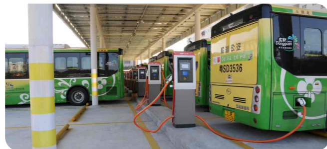
东莞市松山湖光伏充电站
