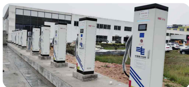
南方电网珠海供电局充电站
