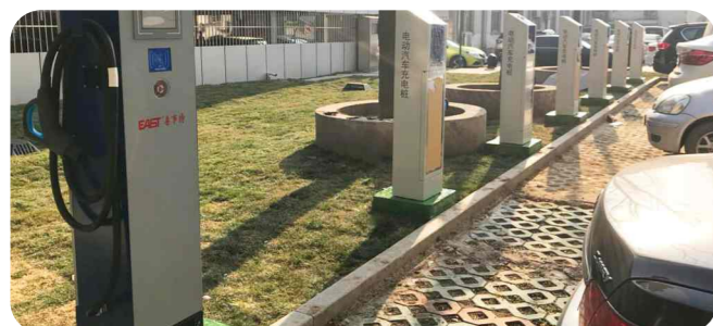
镇江市第四人民医院充电站
