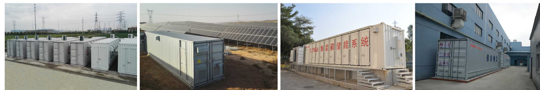
江苏昆山3MW/22.5MWh储能电站 宁夏光伏电站增储6MW/14.4MWh储能电站 易事特厂区250kW/1.2MWh储能电站 浙江某工厂1MW/8MWh储能电站
