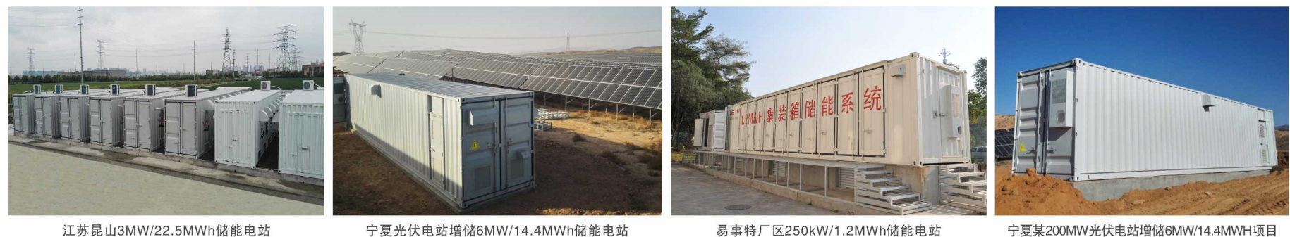
江苏昆山3MW/22.5MWh储能电站 宁夏光伏电站增储6MW/14.4MWh储能电站 易事特厂区250kW/1.2MWh储能电站 宁夏某200MW光伏电站增储6MW/14.4MWh项目
