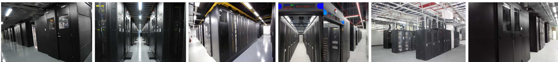
腾讯大数据中心
