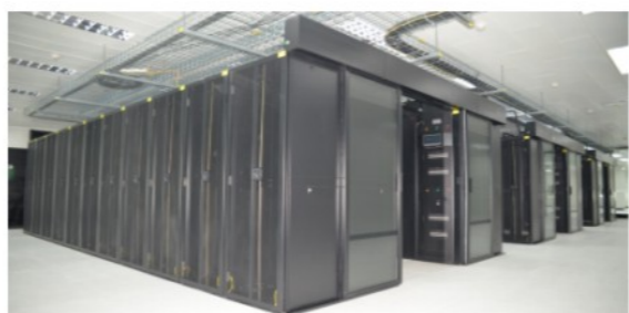
图9河源电子政务冷通道数据中心（易事特冷通道解决方案）
