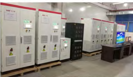
(a) 2MW微电网示范工程现场内部照片
