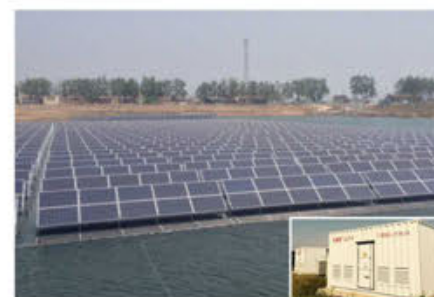
亚洲最大水面光伏电站
